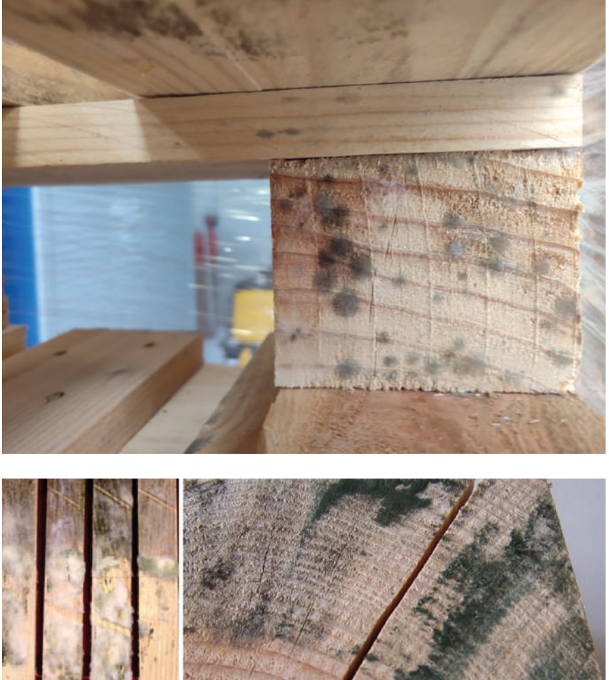
Figure 3 : moisissures en surface de pièces de bois.
